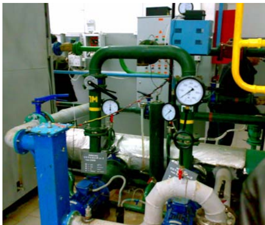
Прилад СІК-2А на котельні мікрорайону Жовтневий міста Кіровоградської ТКЕ, м.Олександрія.
