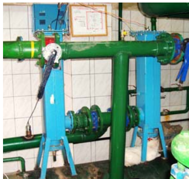
Установка ЩИТ-5/2У на котельні с. Пантаївка Кіровоградського ТКЕ
