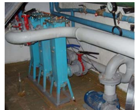
Установка ЩИТ-5/2У на котельні №1 м. Олександрія Кіровоградського ТКЕ
